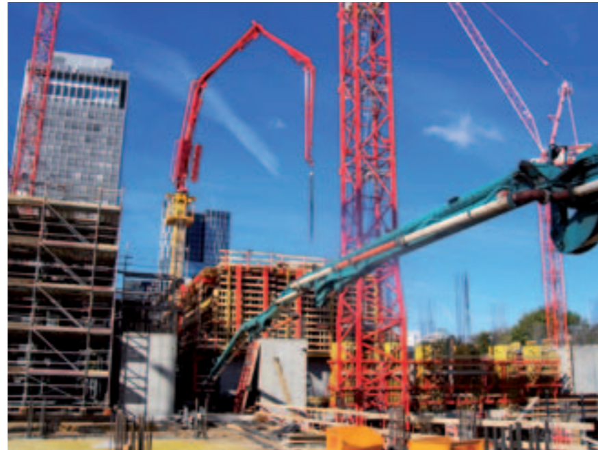
Der MX-Mast steht frei und ohne Gegenballastierung auf der 16 m hohen Rohrsäule
