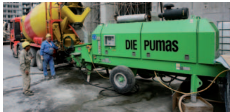
Die BSA 2109 H D ist über eine 80 m lange horizontale ZX-Förderleitung mit der 170 m hohen Steigleitung verbunden
