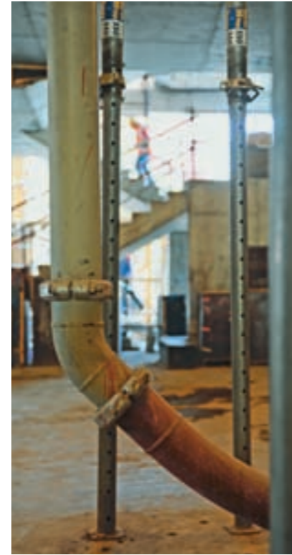
▲ Förderleitungsübergang von horizontaler in vertikale Leitung
